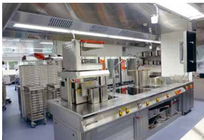
9. 11. 2015: Die neue GERBE-Küche ist betriebsbereit.
