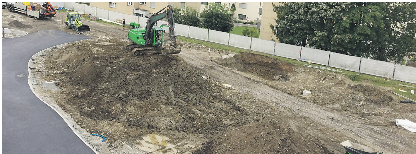
Wo dereinst Bäume und Sträucher stehen: Der Gerbe-Park präsentiert sich derzeit als grosse Baustelle.
